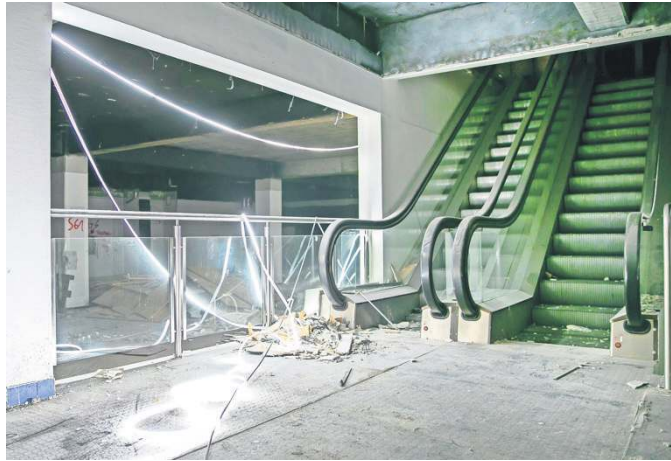
Die Rolltreppen stehen still – und führen ins Dunkel.
