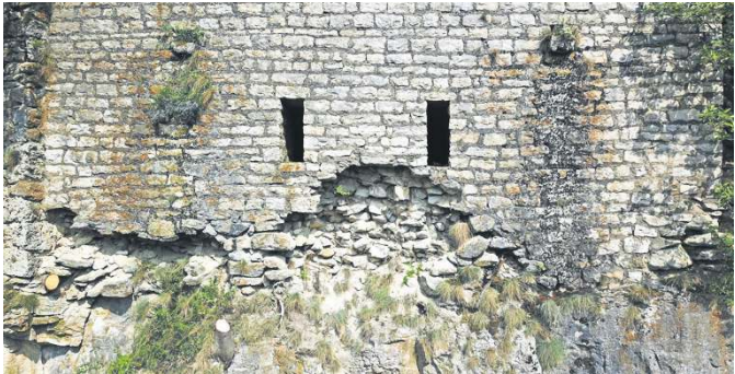
Das Mauerwerk am Gewölbekeller der Ruine Reußenstein ist ausgebrochen.
